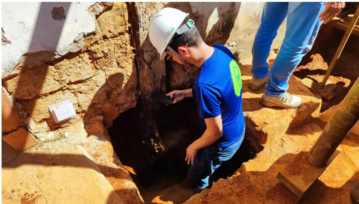
Prospecções estruturais e abertura de valas para reforço estrutural de fundação Autoria: Francielle Ferreira Data: 06/08/2024
