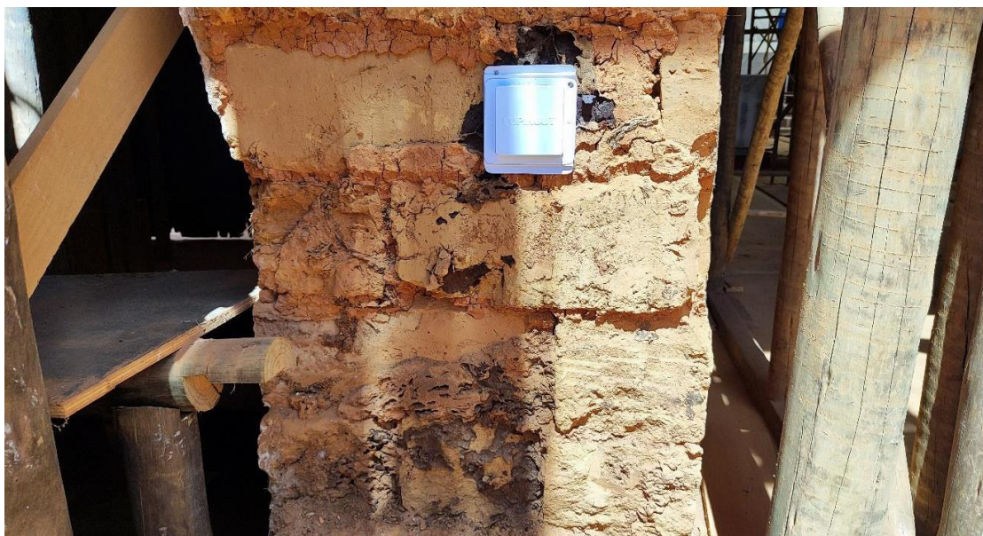
Armadilha para remoção de cupim de solo – alvenarias das fachadas externas Autoria: Francielle Ferreira Data: 06/08/2024
